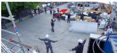
Figure 11 : Photo du lieu où se déroulaient les échauffements au démarrage de l'étude
